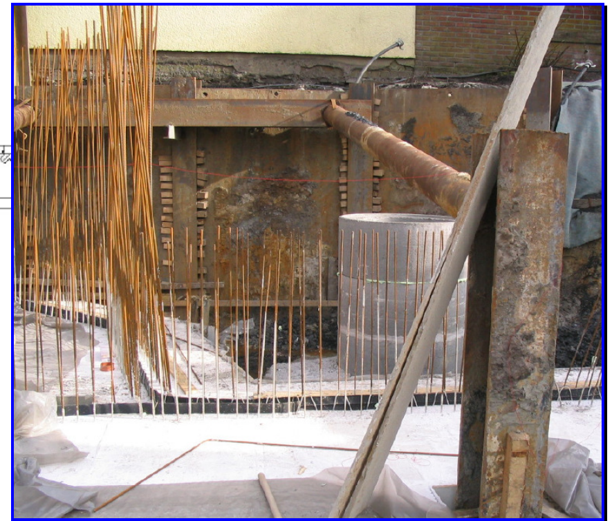
Bild 2, Verbauwand mit vorgespannter Aussteifung und starker Verkeilung ⇒ Verformungsarme Ausführung der Verbauwand zur Stützung des durch die nicht unterkellerte Nachbarbebauung belasteten Baugrundes. Die Steife stützt sich gegen im Boden eingespannte Konterbohrträger.
